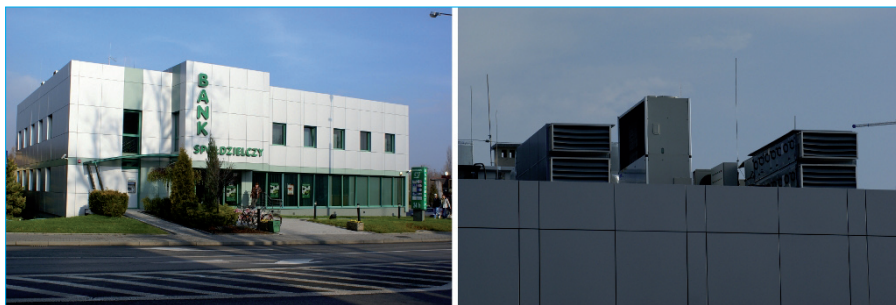
Rys. 4. Instalacja GHP AISIN w banku w Skoczowie. Układ AWS 45 kW
