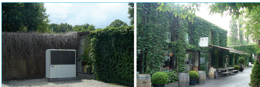
Rys. 7. Instalacja GHP AISIN w restauracji/sklepie Wine Bar Mielżyński w Warszawie. Układ GHP AHU Dx 50 kW
