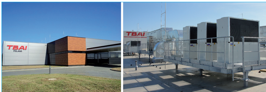
Rys. 5. Instalacja GHP AISIN w zakładzie produkcyjnym TBAI Poland w Wykrotach koło Bolesławca. Układ GHP Dx 220 kW
